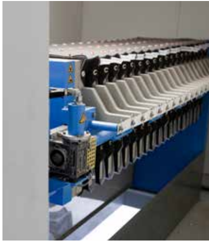
Presse à boue filtrant les eaux chargées pour récupérer les fines.
